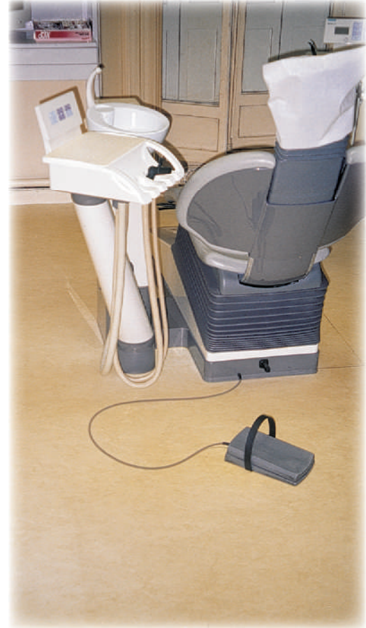
Fig.6. Le sol de ce cabinet est recouvert d'un revêtement thermoplastique, matériau supportant le nettoyage avec un produit normalisé
