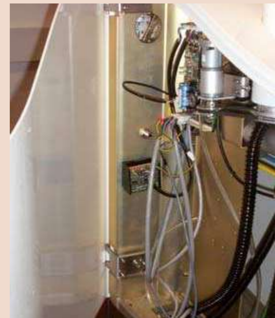
Un regard indiscret sur l'intérieur de l'installation Heka : sobre, précis, solide
